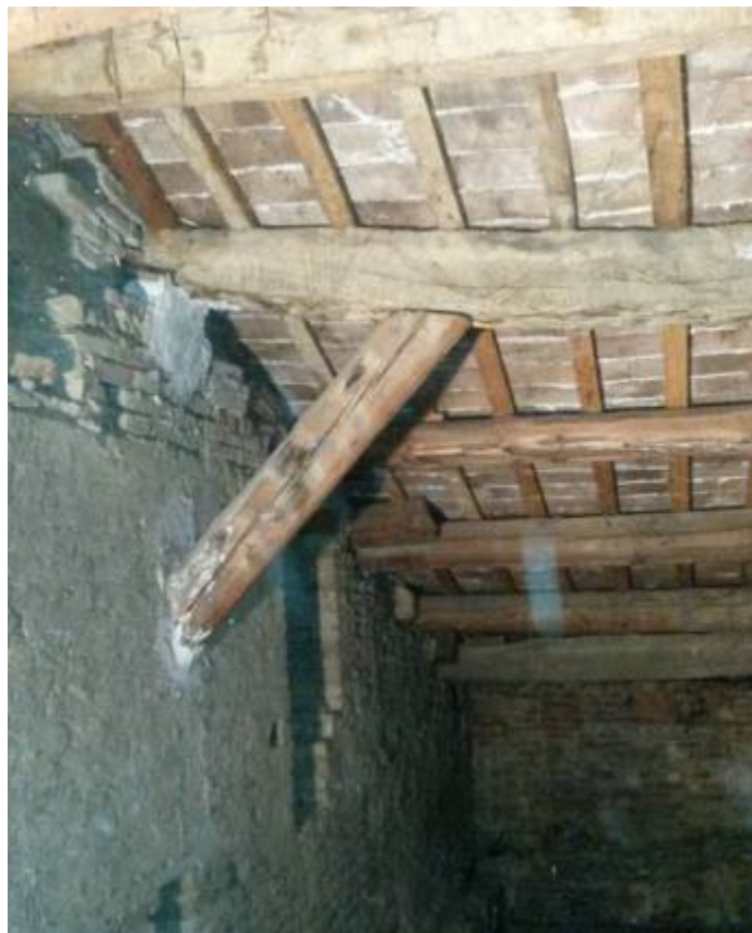
Campata interna con travature da sostituire per eccessiva inflessione - appoggio
