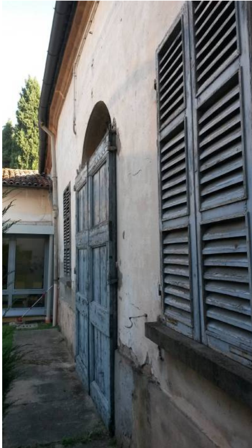
Fronte sul retro - dettaglio parete con fuori piombo per distacco dalle pareti di controvento
