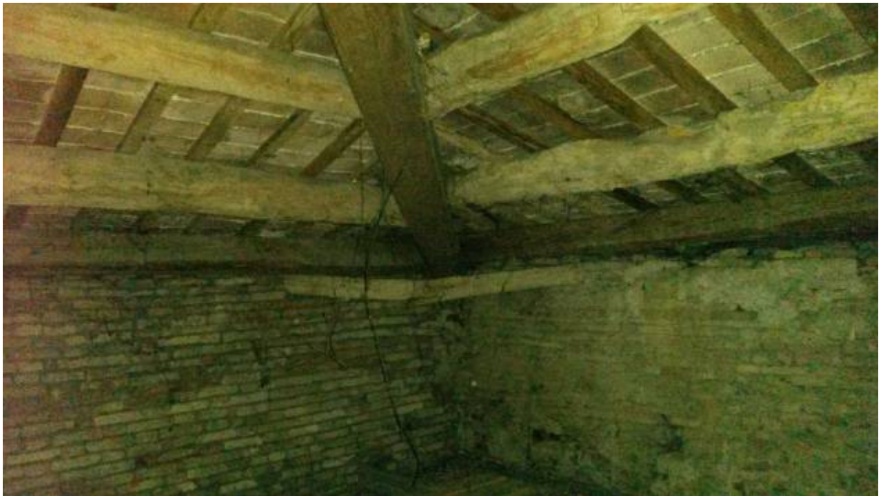
Dettaglio appoggio rompitratta cantonale da sostituire
