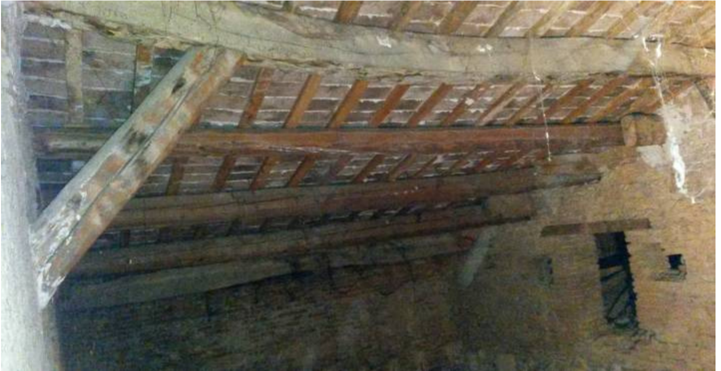
Campata interna con travature da sostituire per eccessiva inflessione
