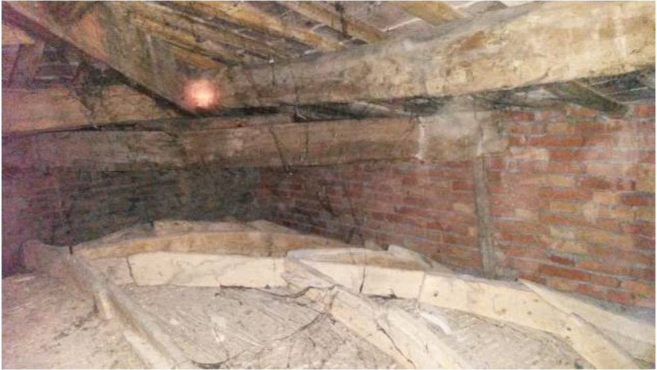
Dettaglio appoggio rompitratta cantonale da sostituire
