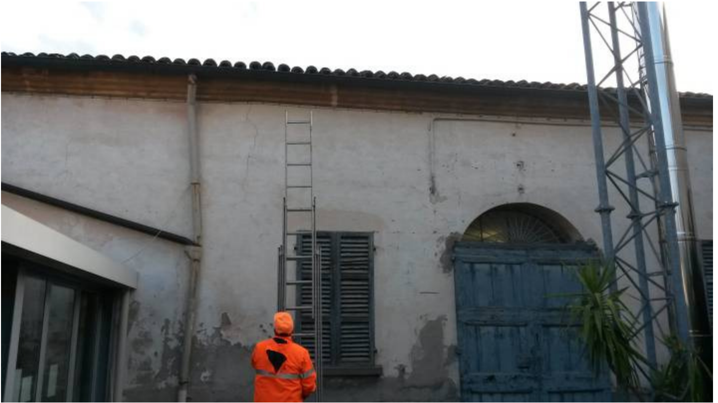
Fronte sul retro - dettaglio parete con fuori piombo per distacco dalle pareti di controvento
